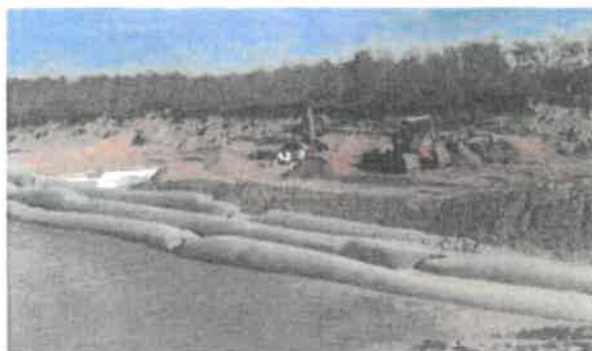
FIGURE 2 PROTECTION EN TUBES GEOTEXTILES EN 2002
